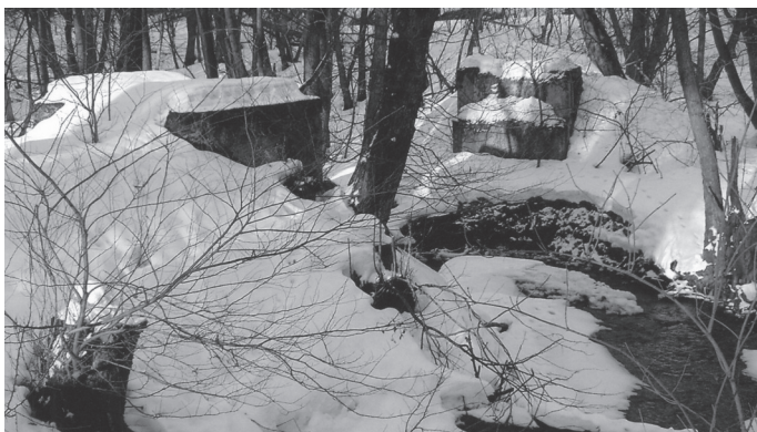
Zvyšky mosta lesnej železničky
